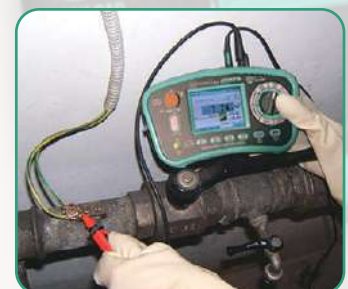
Continuity check of equipotential bonding
